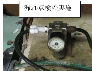
本社工場 エアー漏れ点検 (14 箇所)
